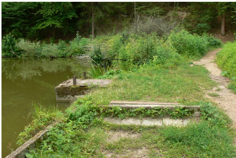
Obr. 1-2: Snímek vypouštěcího zařízení, které je nutné zrekonstruovat.
